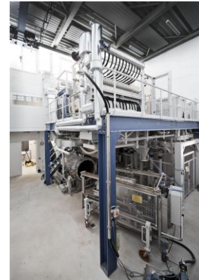
Die neu errichtete Pilotanlage liefert täglich 100 Kilogramm Celitement®. (Foto: Markus Breig)
